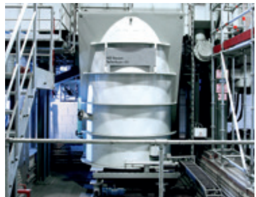
Abgusskarussell des Vakuuminduktionsofens
